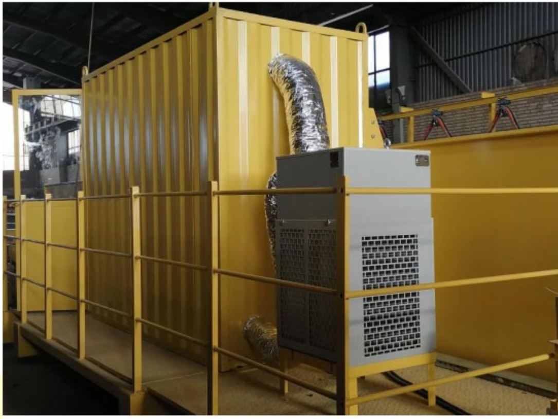
اتاق برق مجهز به کولر صنعتی دائم کار
